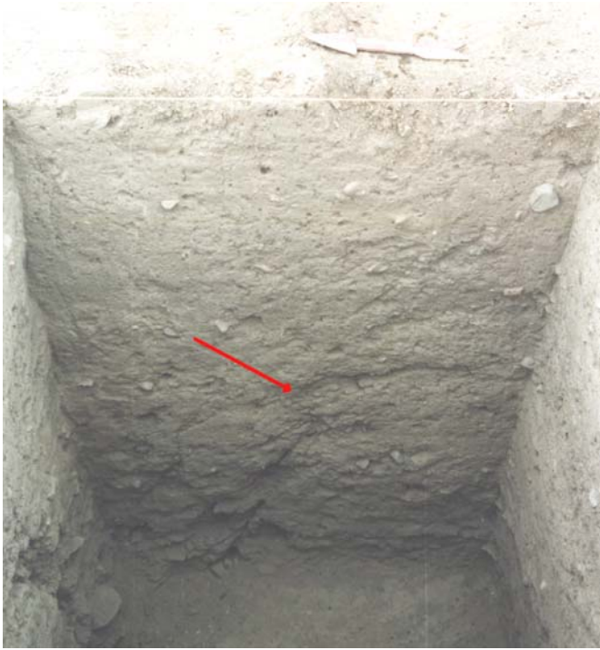
Figura 5. Unidad 2, perfil este. Nótase el agrietamiento de forma cóncava.
